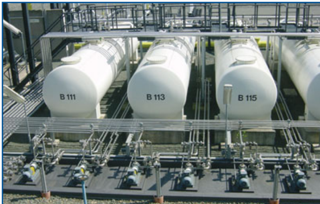
Pompaggio di additivi per olio lubrificante in Germania Pumping of lubricating oil additives in Germany Bombeo de aditivos para aceite lubricante en Alemania
