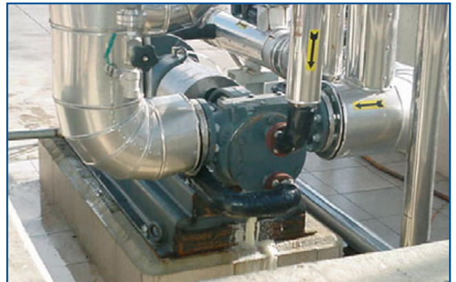
Pompa installata in un impianto per produzione di detersivi Pump installed in a detergent production plant Bomba instalada en una planta para producción de detergentes
